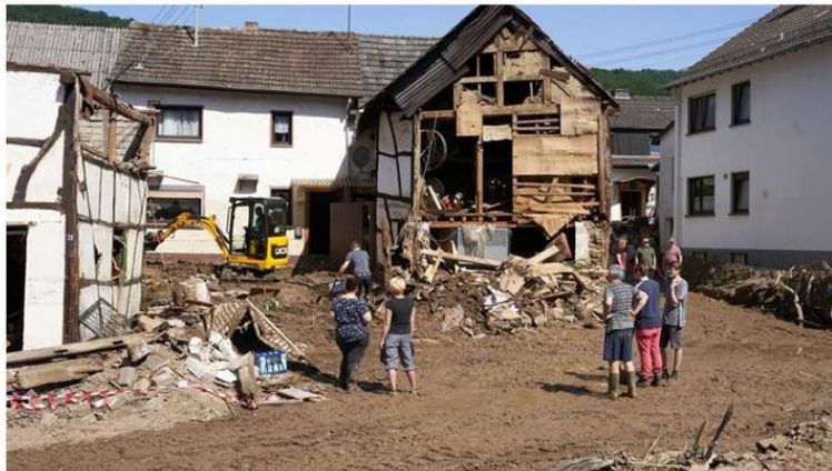
Im kleinen Ort Schuld im Ahrtal stehen Menschen nach der Flut im Juli 2021 vor einem stark beschädigten Wohnhaus. © Thomas Frey/dpa
